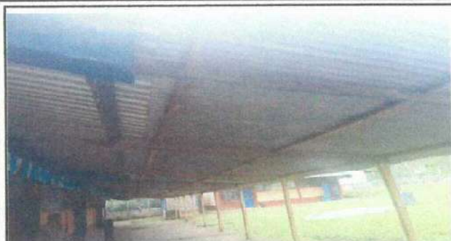
Foto 1: Muestra el entechado del corredor a sustituirla
